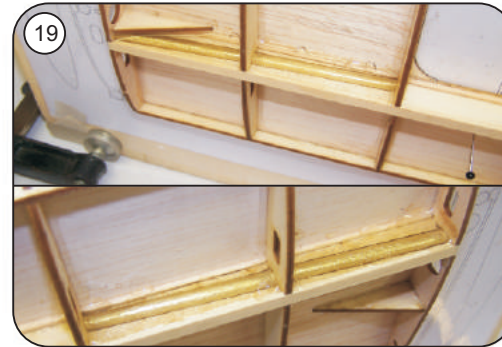
F 23 beidseitig zum Kammholz satt einharzen, Baubrett dazu jeweils bis zum Trocknen senkrecht stellen
